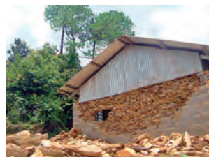
ネパール地震で被災した学校の校舎
