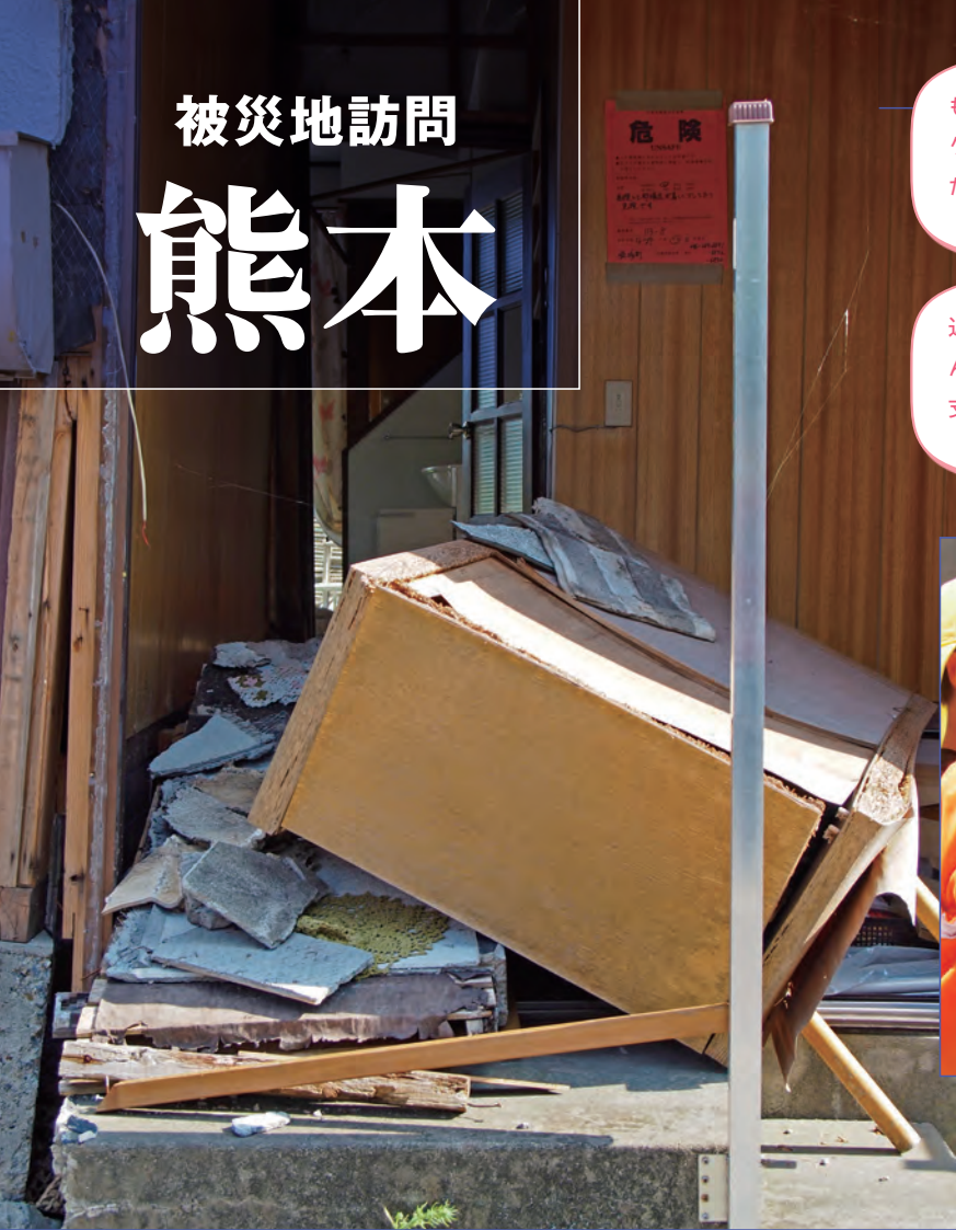
「危険」の札が貼られ、立ち入ることのできない家。
